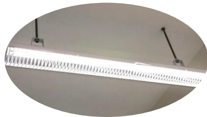
課室內安裝T5節能 光管、節能照明系統
